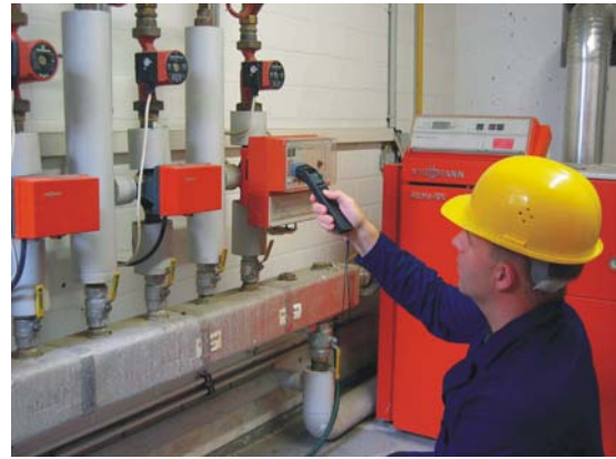
Überprüfen der Temperatur an Heizkreisen
